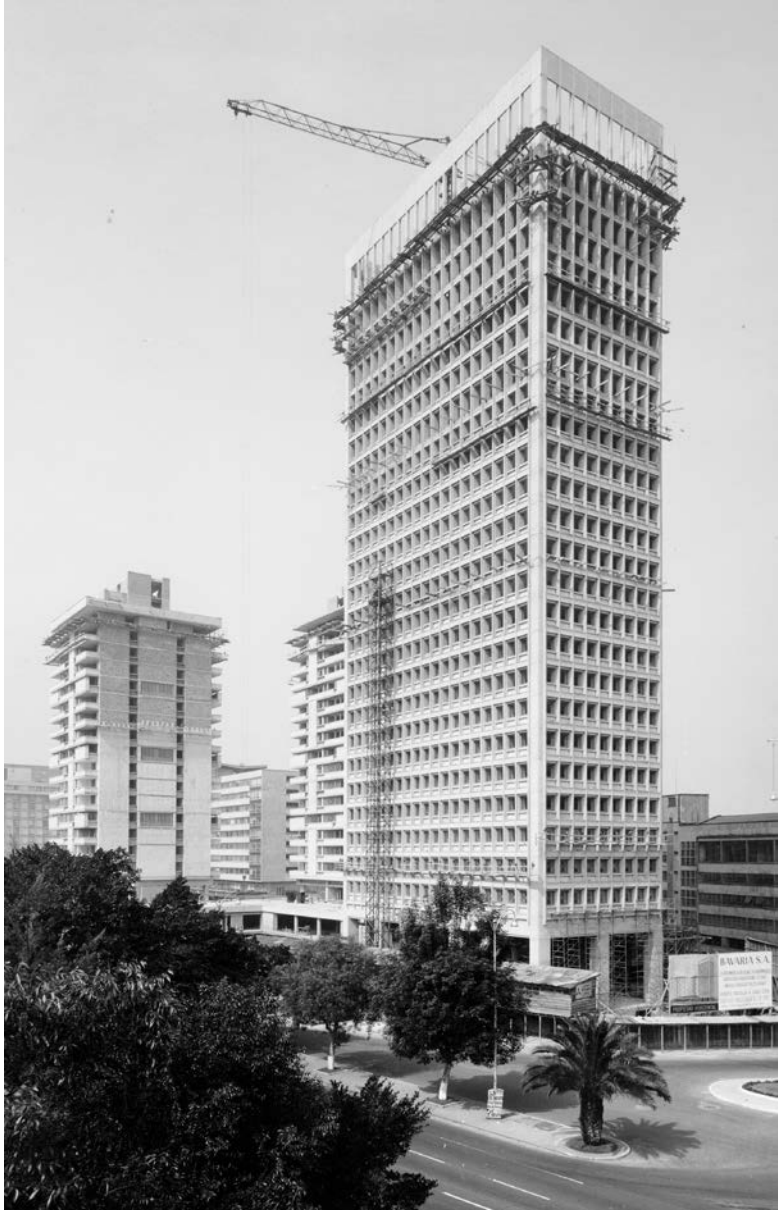
Construcción de las torres del Conjunto Bavaria. Paul Beer. Fuente: Museo de Bogotá. Fondo Paul Beer MdB 24905
